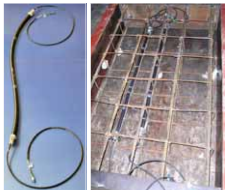
Einbetonierbarer Dehnungssensor (links) / fertig montiert in einen Bewehrungskorb (rechts)
